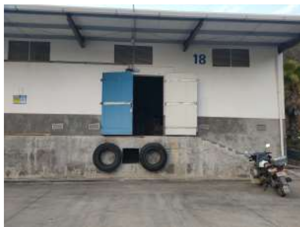
18#成品库未配备灭火器
