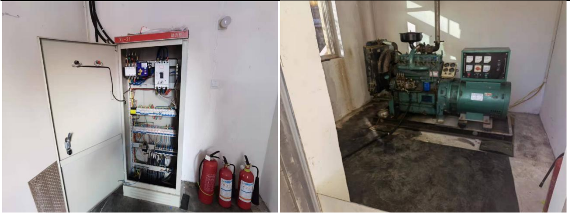
发电机间及配电间
